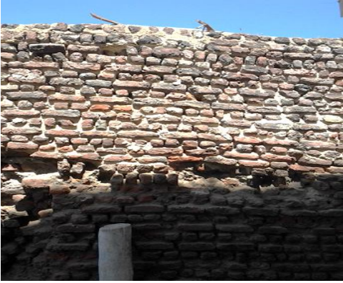
اللوحه (١٤) بقايا جدران في موقع برج مغيزل يرجح نسبتها لعصر محمد علي
